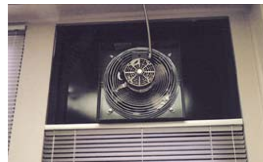
Room exhaust fan
