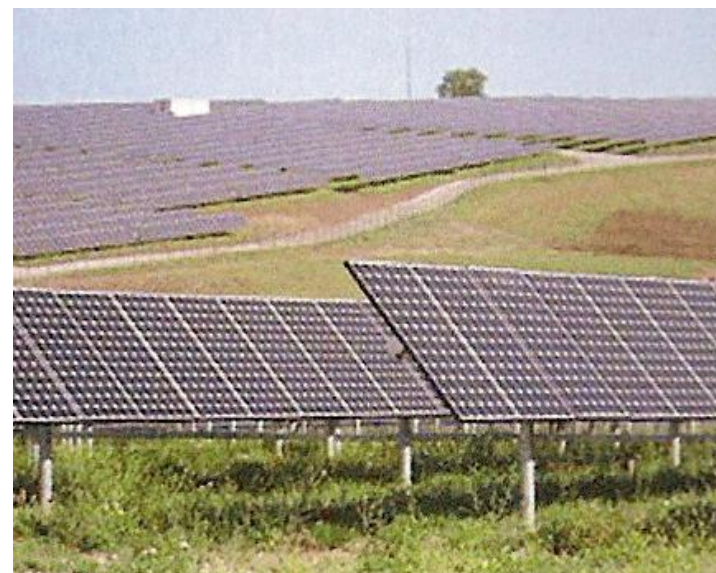
Energia solar. Central da Amareleja.
