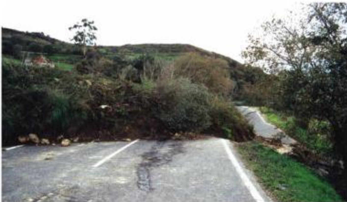
Escorregamento complexo da Serra de Alrota (Bucelas), Inverno de 2001. Estrada cortada pelo escorregamento.
